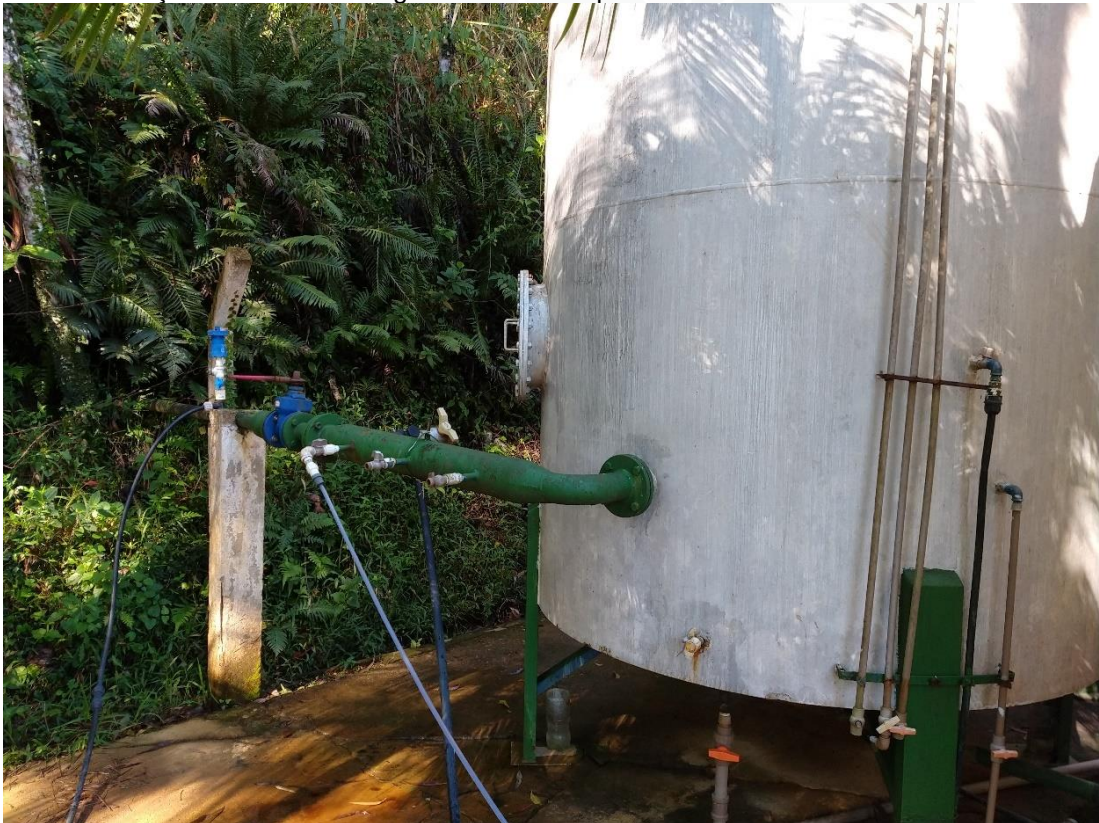
Figura 19: Tubulação de entrada da água bruta no tanque Floccodecantador
