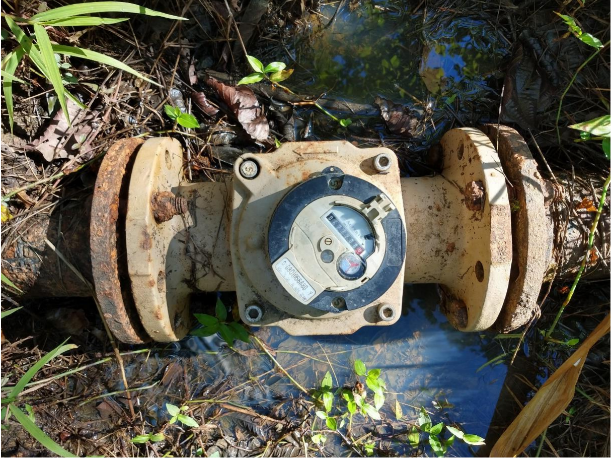
Figura 23: Macromedidor na saída da reservação.
