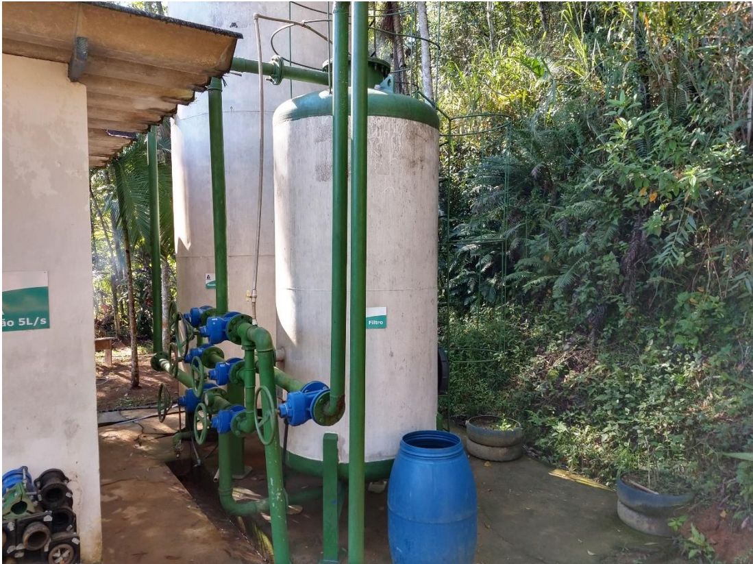
Figura 18: ETA – Floccodecantador e filtro
